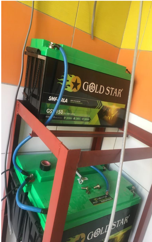
Batterijen voor Solar
