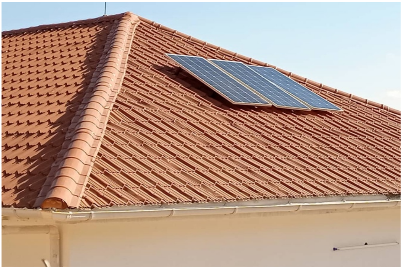
Zonnepanelen op het dak van het centrum
